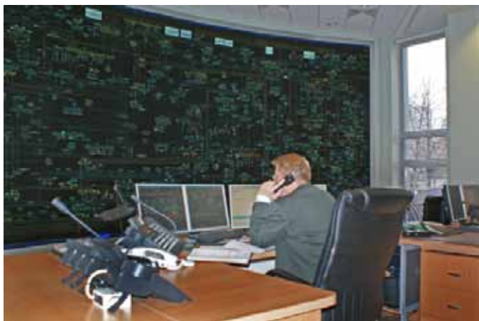
Современный видеопроекционный диспетчерский щит в филиале ОАО «СО ЕЭС» — Московском РДУ
