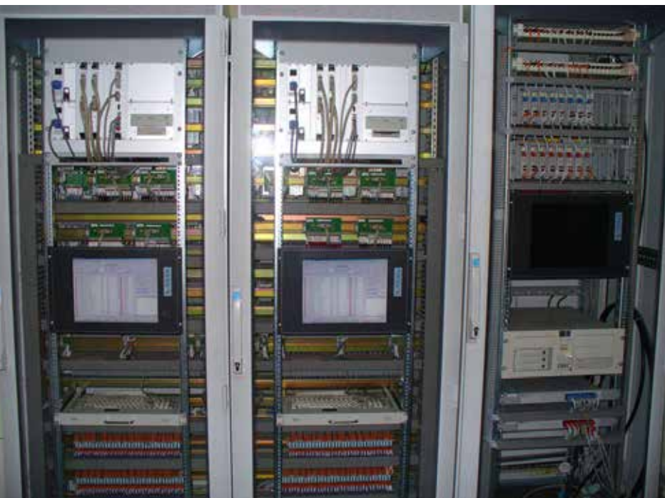
Комплекс противоаварийной автоматики АПНУ
