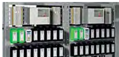
Устройства регистрации аварийных событий и процессов
