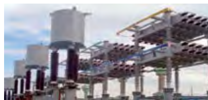
Батареи статических конденсаторов
