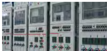
Устройства релейной защиты и сетевой автоматики
