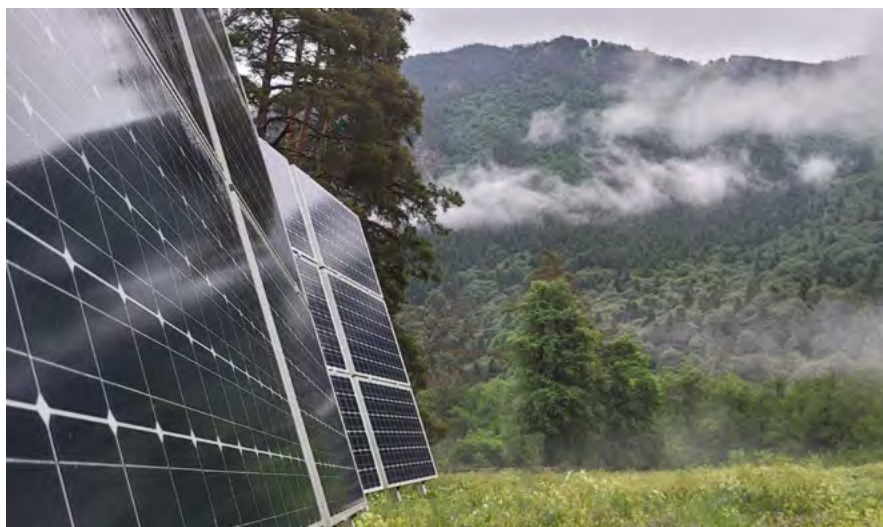
Солнечные панели на кордоне Умпырь
