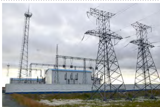
Подстанция 220 кВ Салехард
