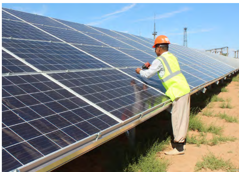
В 2018 году в Астраханской области введена в эксплуатацию солнечная электростанция «Енотаевка» мощностью 15 МВт
