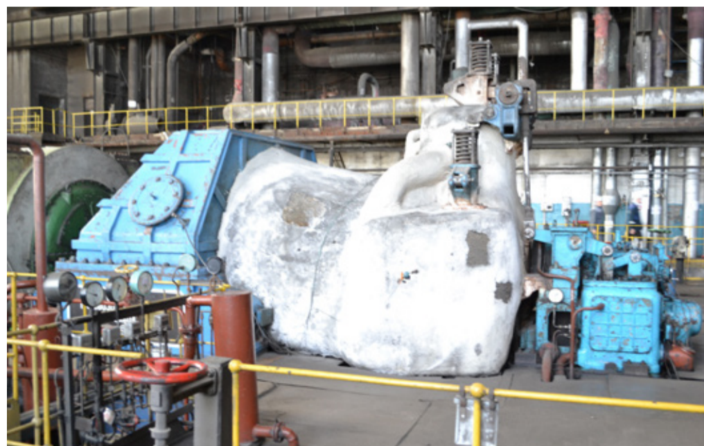
Причиной сложившейся в республике критической ситуации стало неудовлетворительное техническое состояние оборудования ТЭЦ
