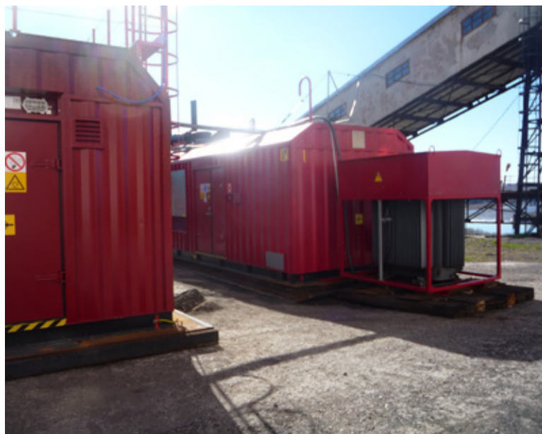
Дизельные электростанции, установленные на площадке Воркутинской ТЭЦ-1
