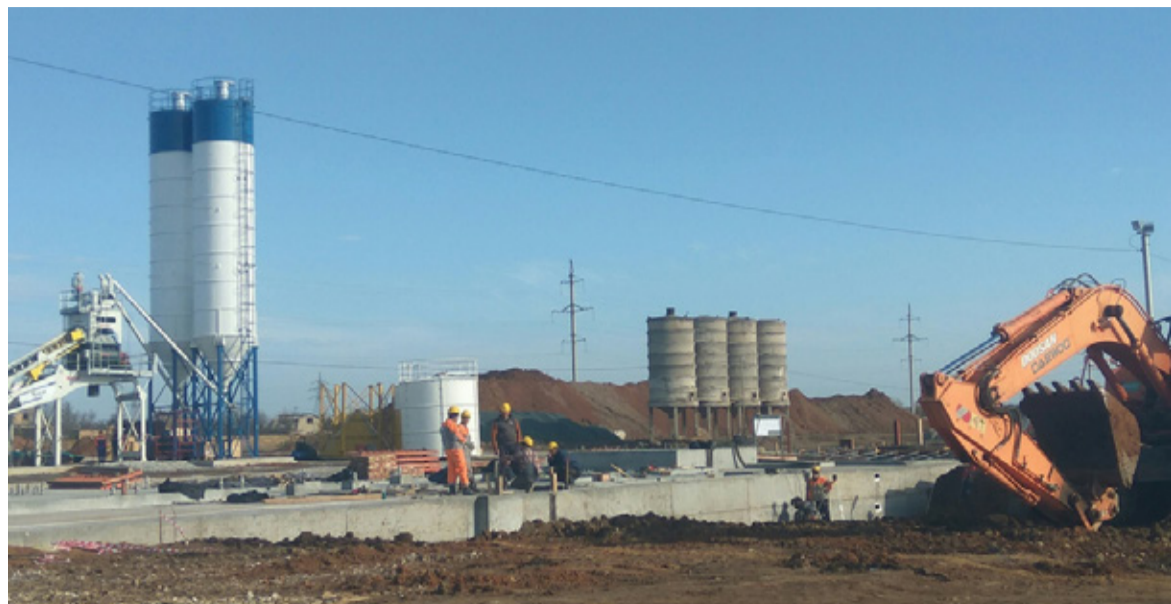
На площадке Сакской ТЭС завершили заливку фундаментов под первые четыре газовые турбины
