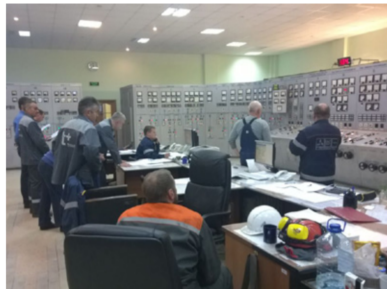
Главный щит управления Воркутинской ТЭЦ-2 во время натурных испытаний, 27 августа 2017
