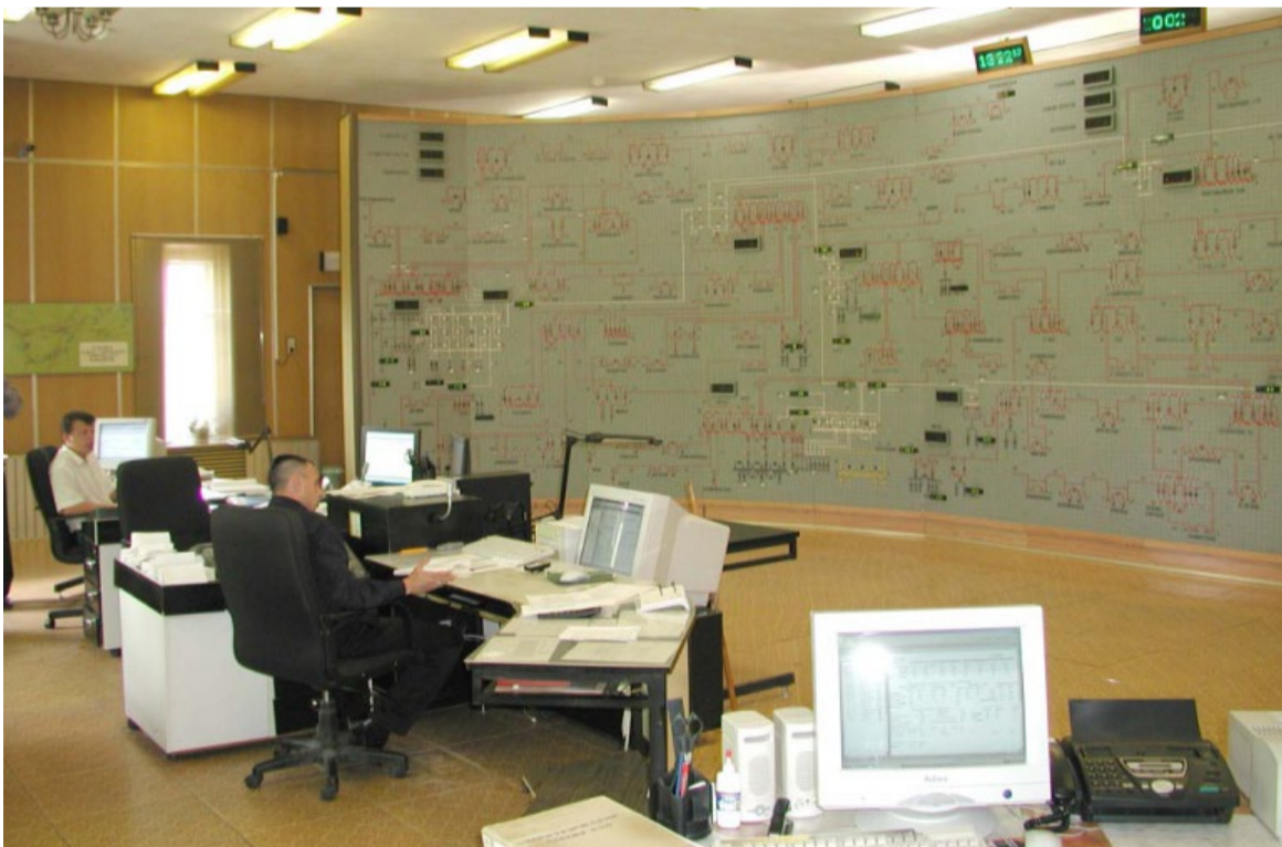
РДУ «Ставропольэнерго», 2002 год
