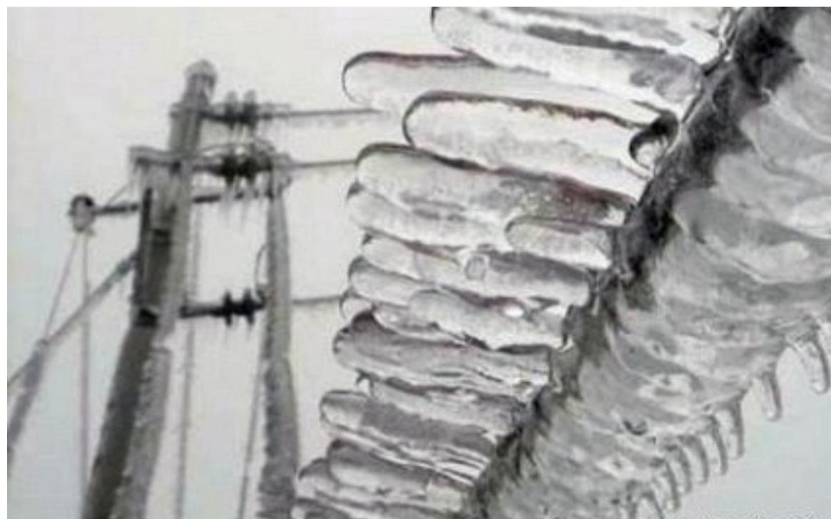
Гололедообразование на воздушных линиях электропередачи
