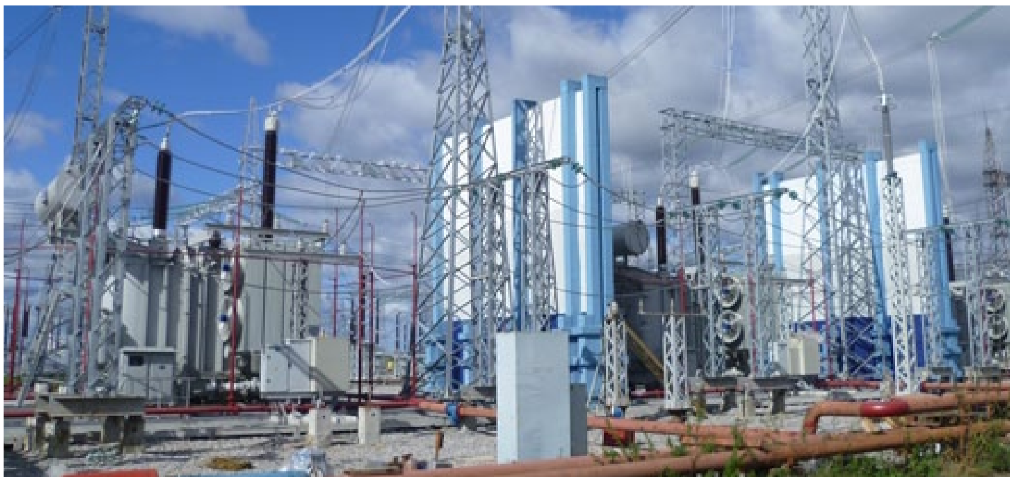
ПС 500 кВ Тюмень
