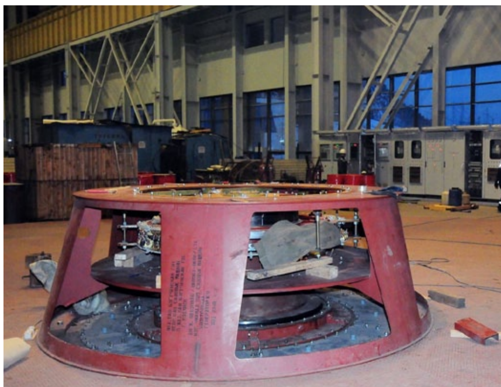
9-я агрегатная секция Богучанской ГЭС
