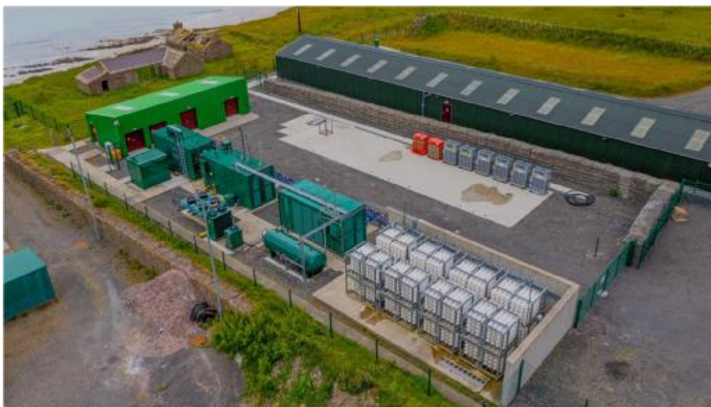
Электролизная установка и здание аккумуляторной СНЭЭ в Калдейле
