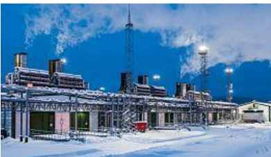
ТЭС Рассолы Руст 144 МВт Год ввода 2018
