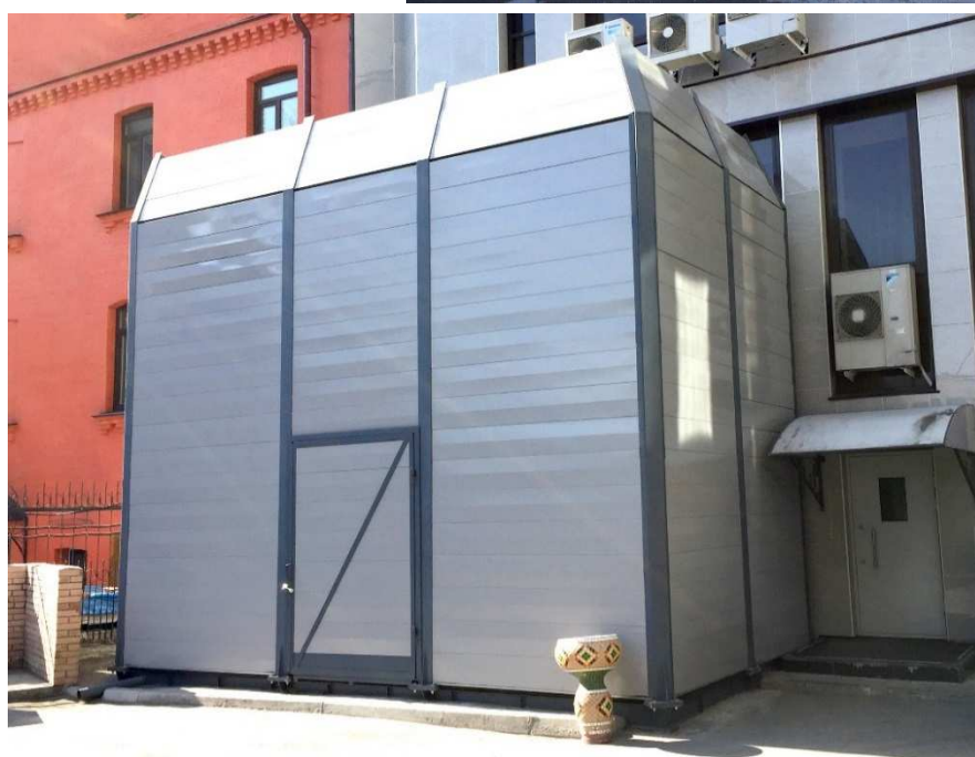
Рисунок 5. ОДУ Востока. Шумозащитная конструкция
